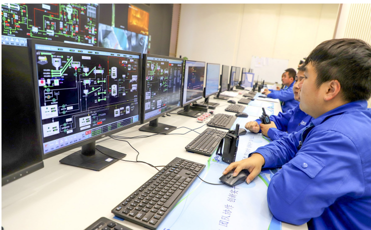
大足循环经济产业园,工作人员实时监控各项运行数据。
